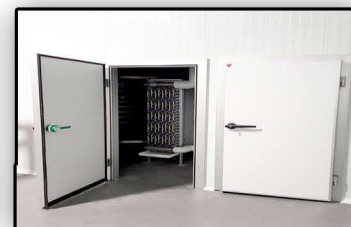
Cold Room Door
